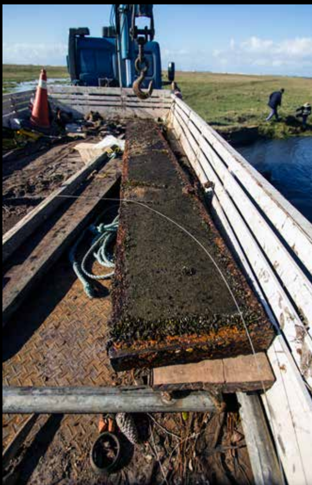
Pranchas da barragem colonizadas por mexilhão dourado. Junho/2014
